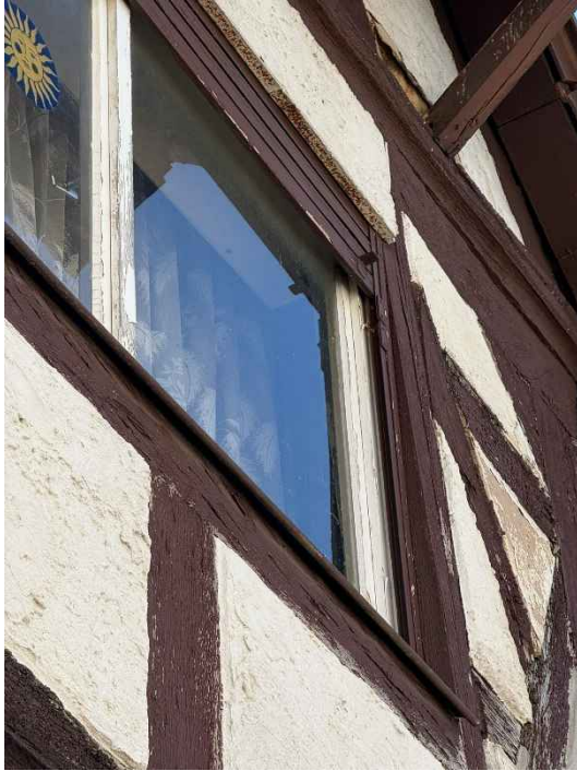
Holzrahmenfenster Obergeschoss / verwittertes Holzfachwerk
