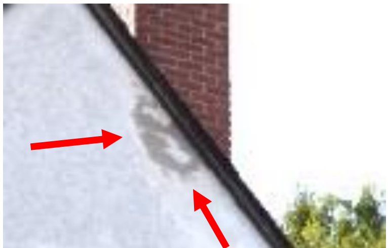
Ausblühungen im Kaminbereich (evtl. Versottung)
