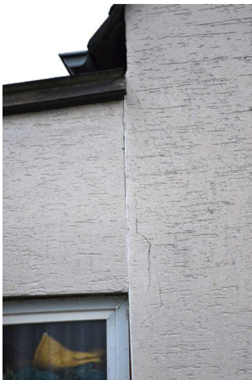
Baumängel - Rissbildung Wohnhaus / Anbau
