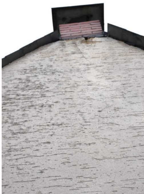
Baumängel - Rissbildung nordwestliche Wohnhausgiebelwand
