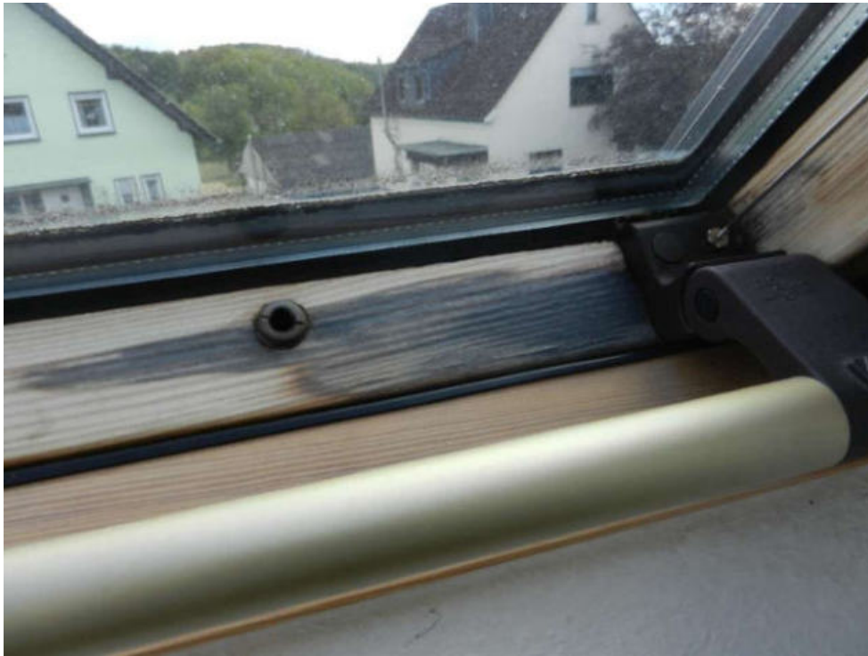
Bild 18: Feuchter Holzrahmen des Dachfensters im Bad (DG)
