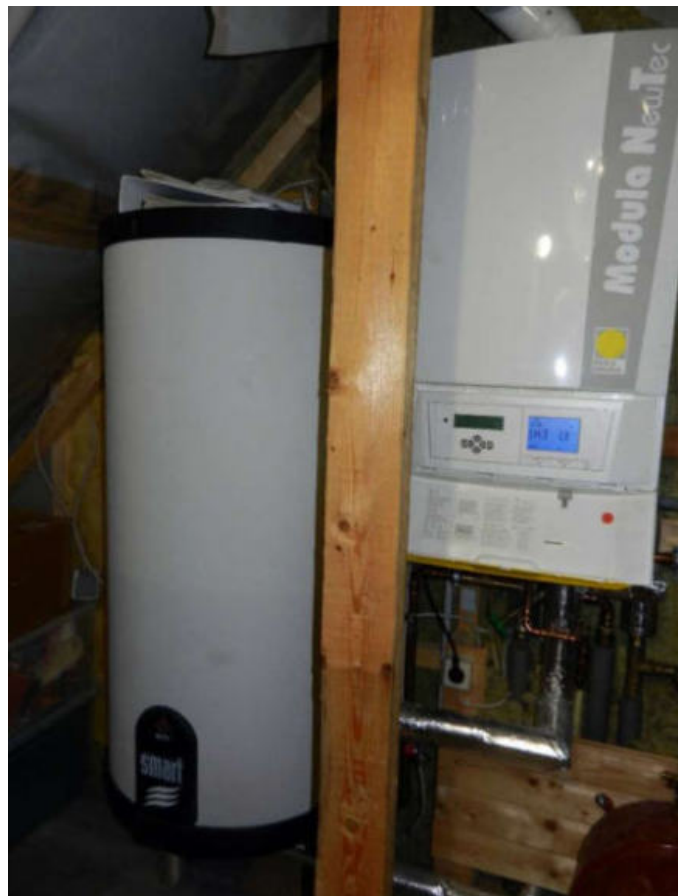
Bild 17: Vermutlich defekte Gastherme im Spitzdach
