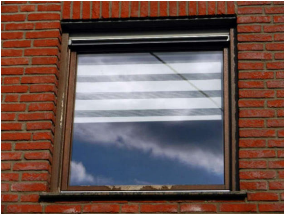
Bild 19: Holzfenster im DG mit abblätternder Beschichtung
