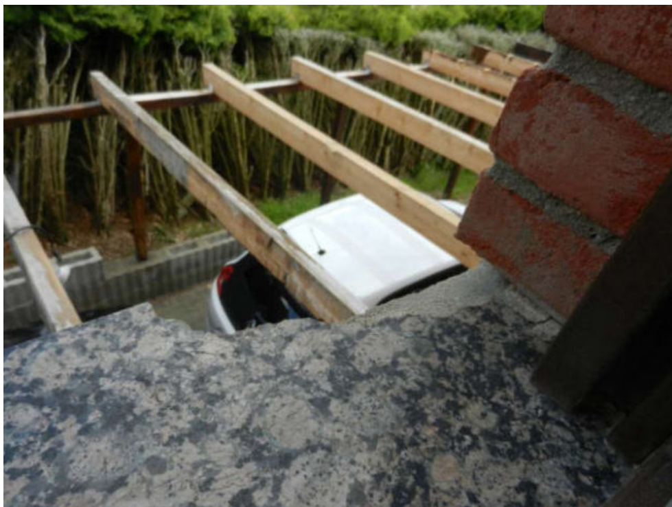
Bild 13: Beschädigte Fensterbank aus künstlichem Granit (DG), hinten Carport ohne Dach
