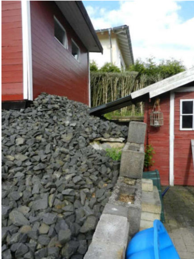
Bild 6: Schadhafte Stütz wand aus Schalungssteinen (kippt)
