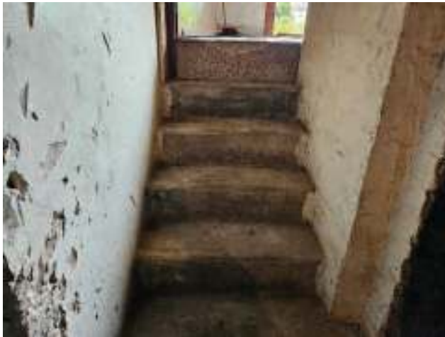
Treppe zum Keller, fehlender Handlauf
