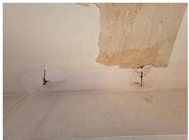
Bild 30 – Beschädigung an der Decke
