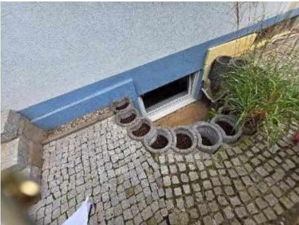
Bild 7 – Abgesenkte Außenflächen, offene Dämmung
