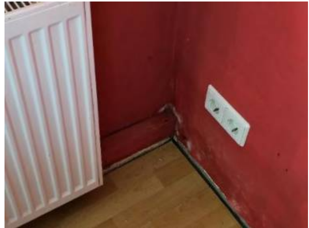
Bild 38 – Feuchtigkeit um Steckdosen
