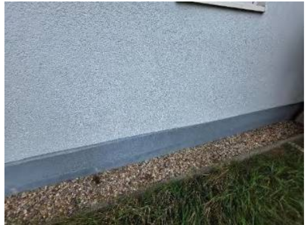
Bild 8 – Rissbildung und Feuchtigkeit im Sockel
