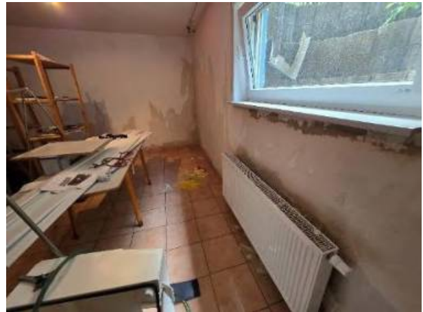
Bild 32 – Fehlende Wandbeläge und Feuchtigkeit
