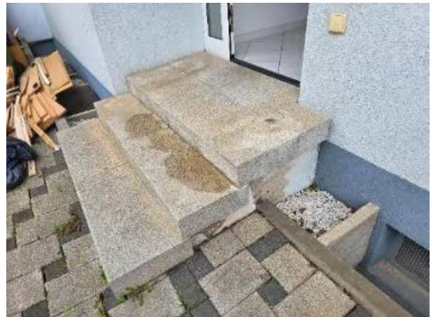
Bild 4 – Treppe mit erhöhter Feuchtigkeit
