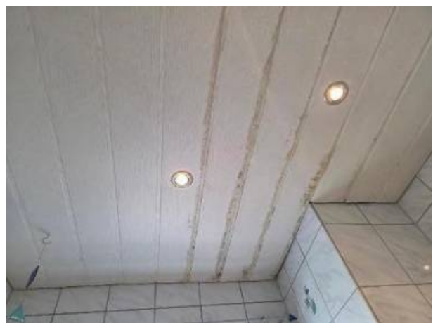
Bild 18 – Feuchte / nasse Decke
