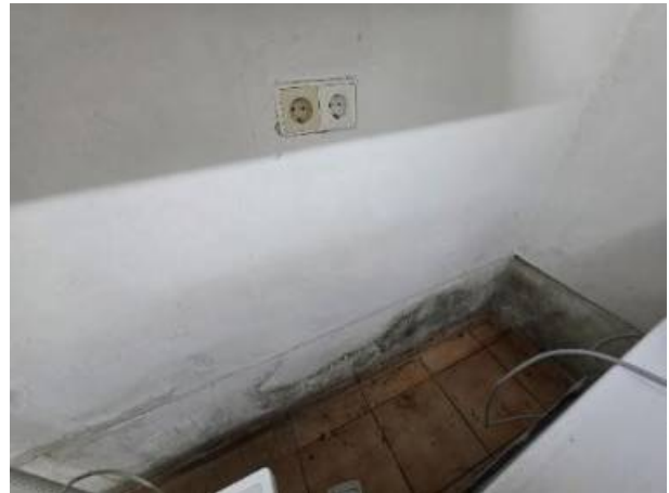
Bild 26 – Feuchtigkeit und Schimmel
