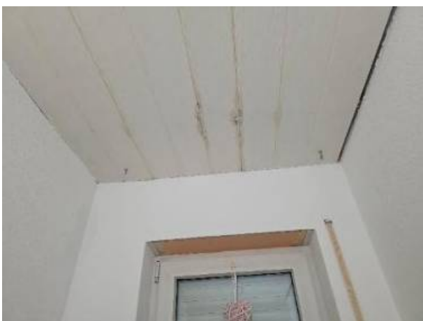
Bild 17 – Feuchte Decke mit Schimmelpilzbildung
