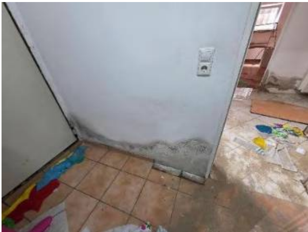
Bild 27 – Feuchtigkeit und Schimmel
