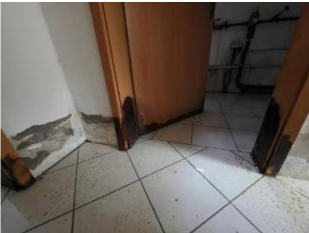
Bild 33 – Beschädigte Türen und Rahmen
