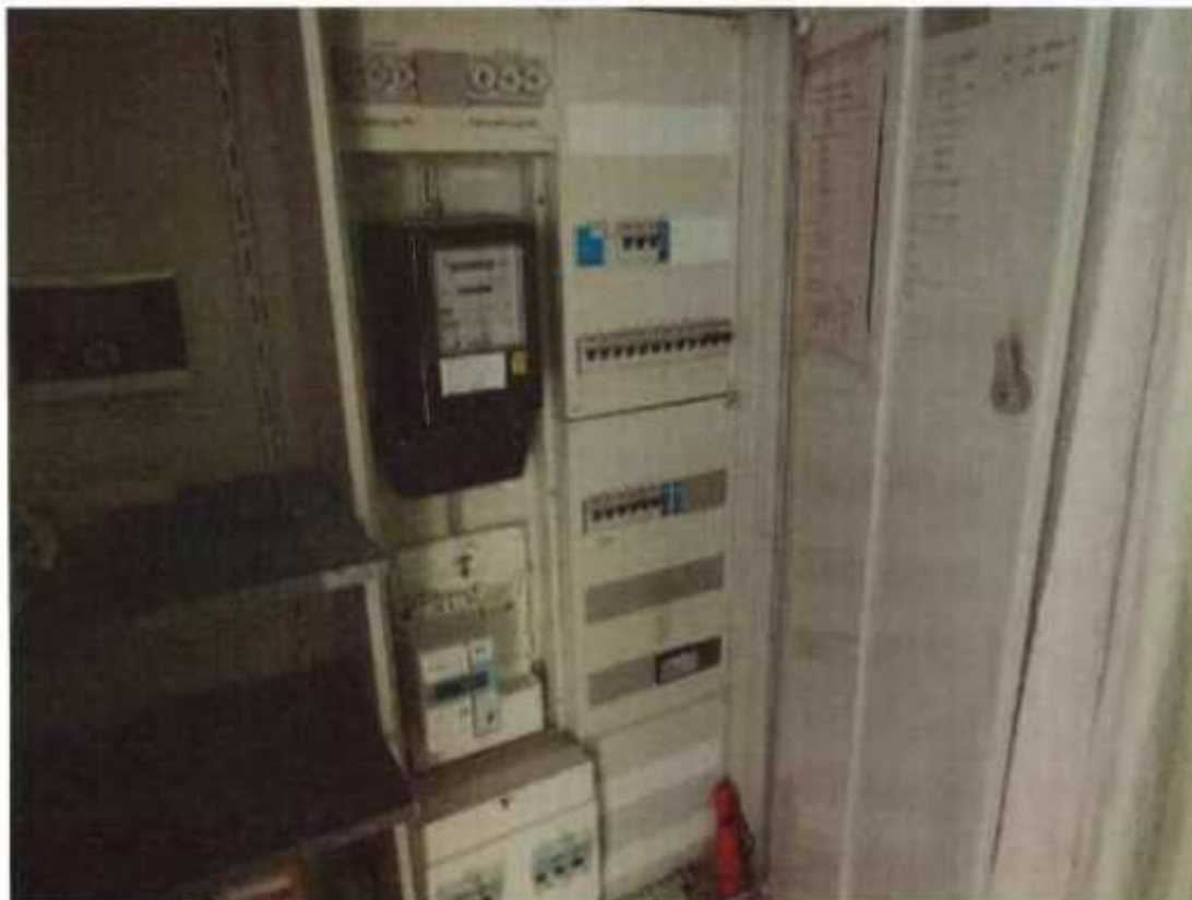
Zähler und Sicherungen im KG
