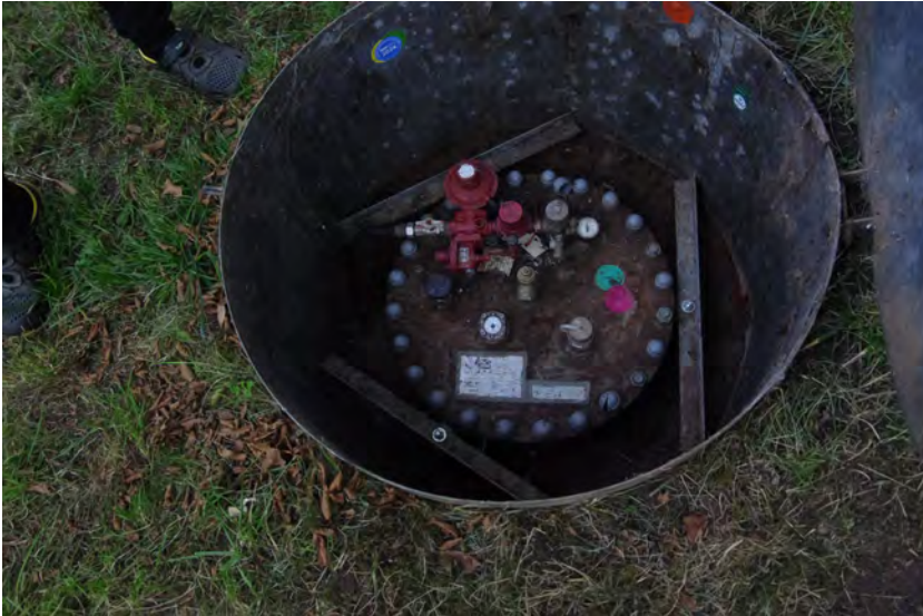
39 Gemeinsamer Flüssiggastank als Erdtank
