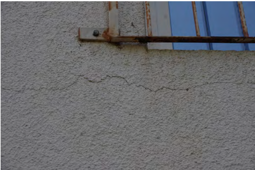
40 Rissbildungen Fassade und fehlende Fensterbank
