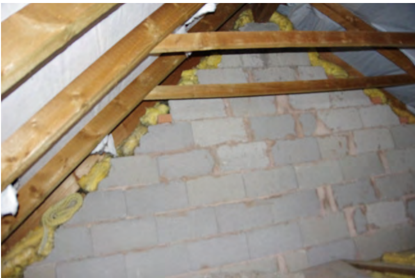
43 Wohnungstrennwand nicht bis unter die Dachhaut geführt (nur mit Dämmung ausgestopft)
