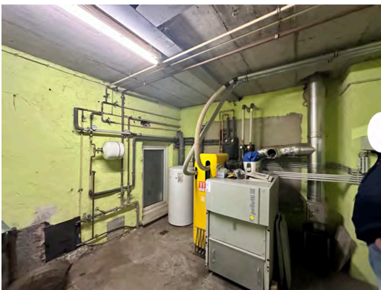
19 Pelletheizung für Haus Nr. 57A
