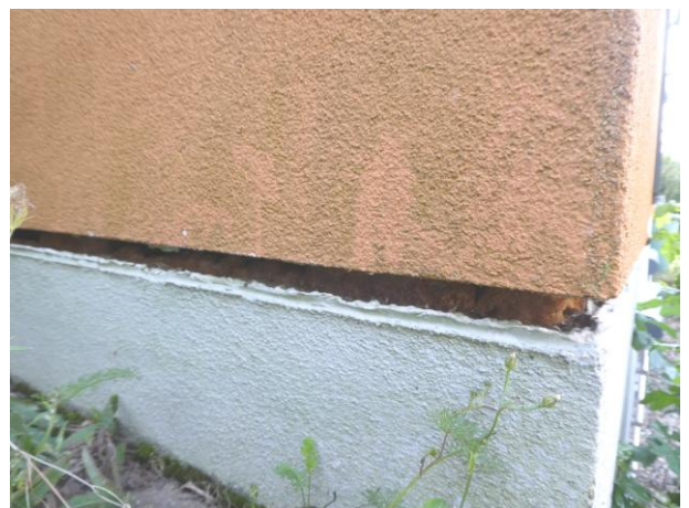
Offene Fuge in der Dämmebene am Übergangsbereich von aufstehender Außenwand und Sockel (Nordwestecke)
