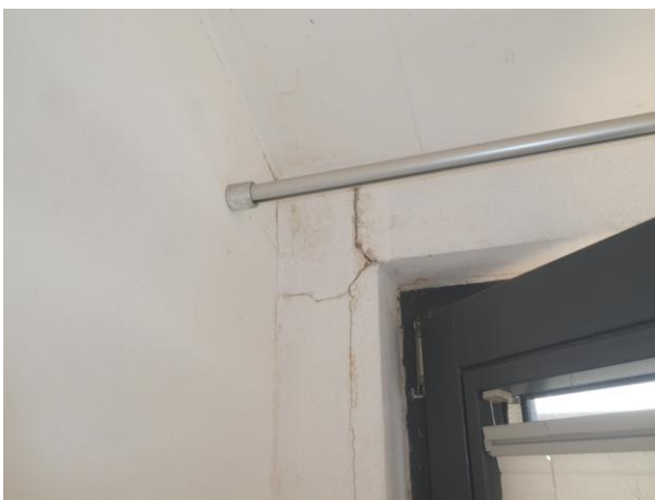
Schaden (Feuchtigkeit) in Einheit OG Ost im Bereich Schornstein-Außenwand
