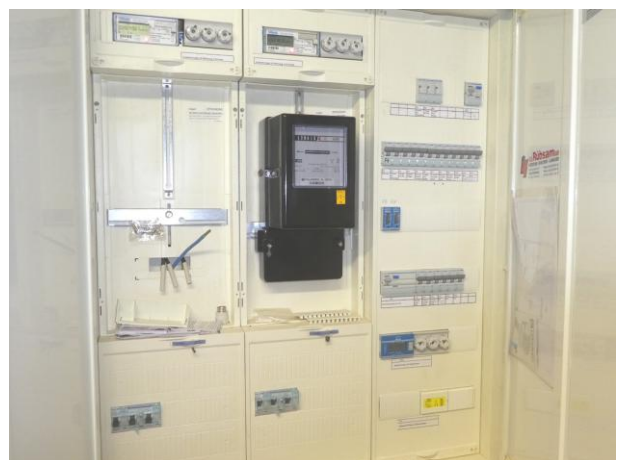
Zählerschrank mit Zwischenzählern (KG)
