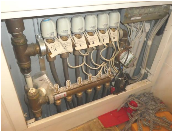
Verteiler für Fußbodenheizung
