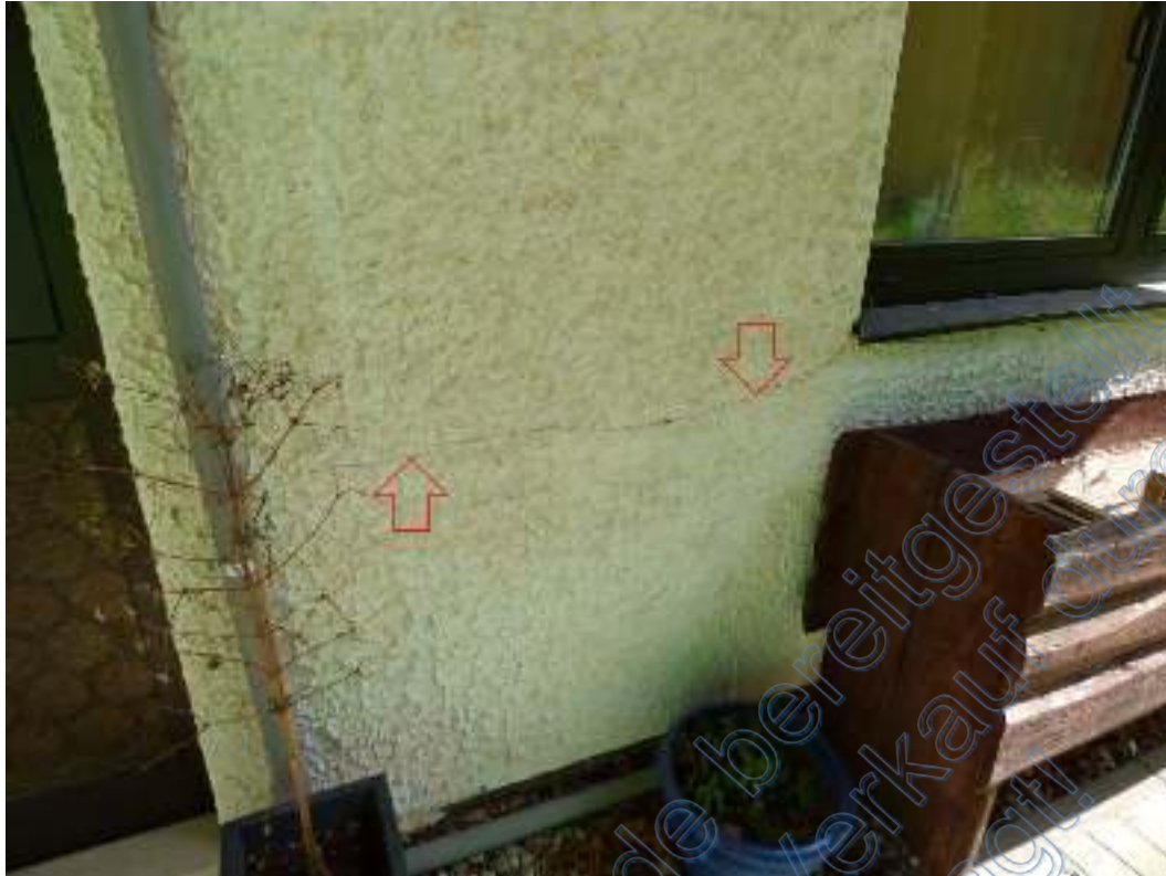
Bild 17: Risse in der Fassade im Bereich des Eingangs
