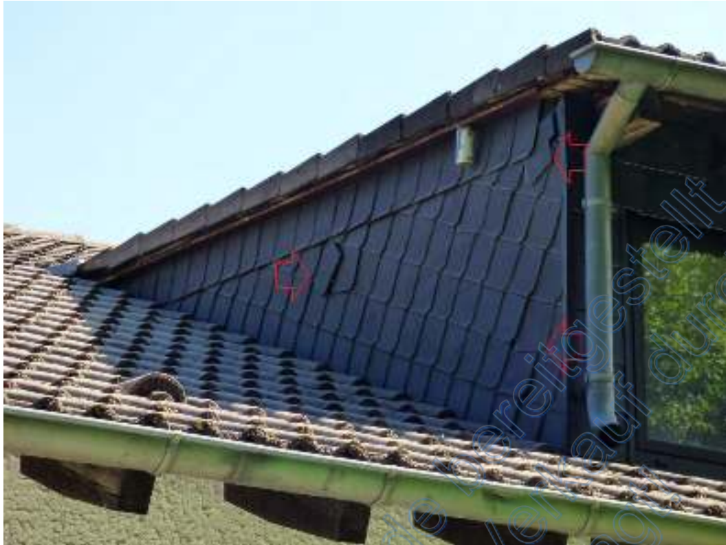
Bild 15: Lose Schindeln an der Dachgaube über dem Eingang
