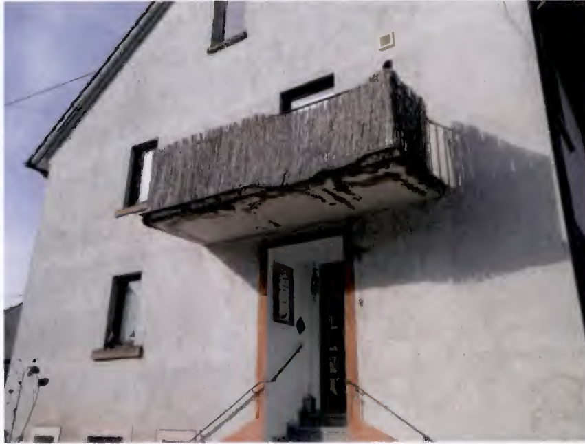
Balkon (nur von unten ersichtlich), Sanierung erforderlich
