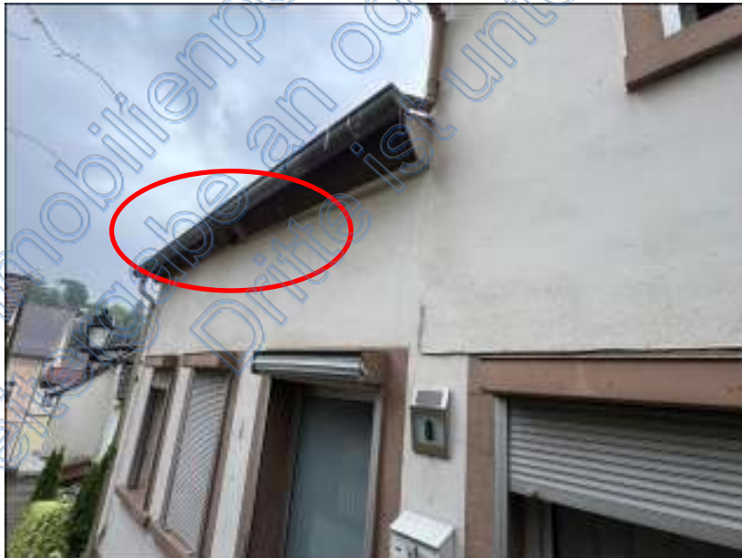
Bild-Nr. 2 erstellt am: 04.06.2025 Schäden am Dachgesims
