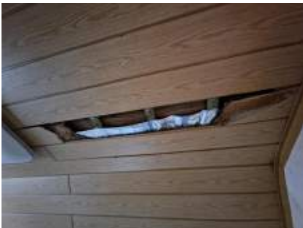
Bild 47 – Beschädigte Holzdecke (DG)
