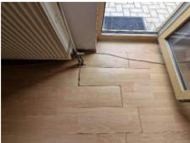
Bild 45 – Aufgequollener Fußboden (DG)
