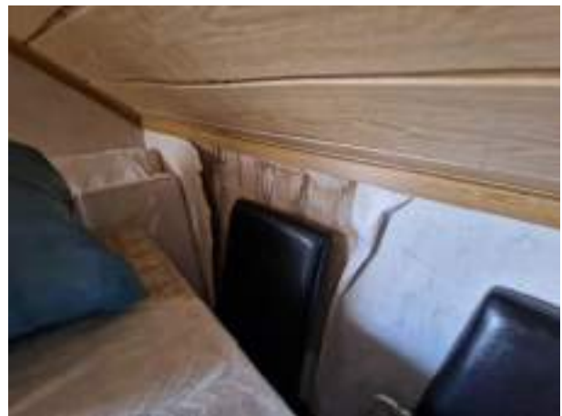
Bild 46 – Rückstände Wassereintritt (DG)
