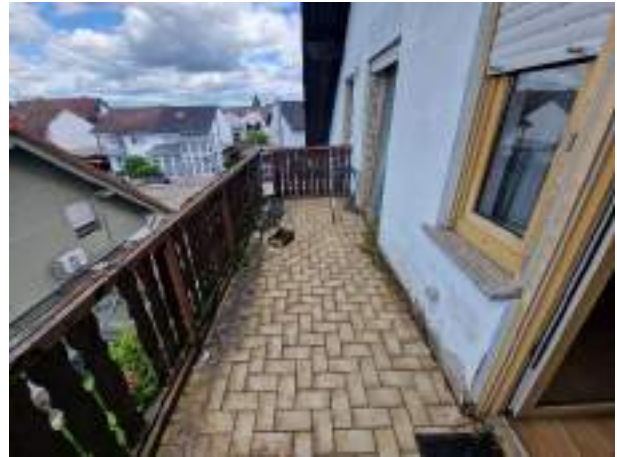
Bild 44 – Beschädigter Balkon (DG)
