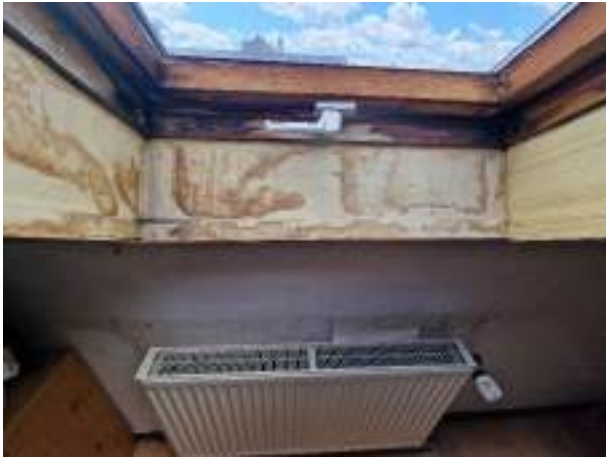
Bild 43 – Rückstände Wassereintritt (DG)
