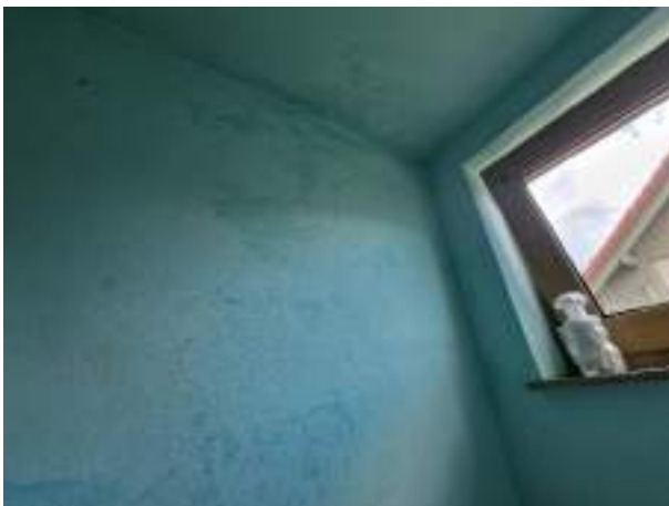
Bild 41 – Rückstände Wasserschaden Gäste-WC (EG)
