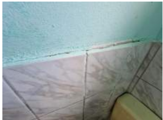
Bild 42 – Rückstände Wasserschaden Gäste-WC (EG)
