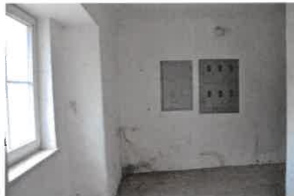
Wohngebäude EG / Vorraum / Zählerkasten
