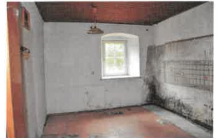
Wohngebäude EG / Küche / Feuchteschaden
