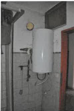
Wohngebäude EG / Badezimmer / Warmwasserboiler
