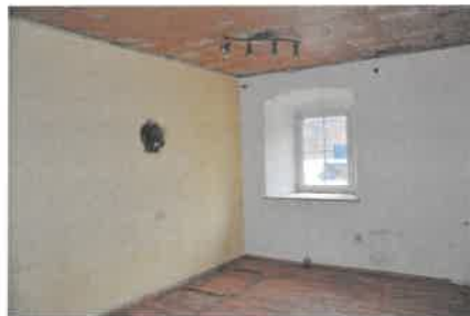
Wohngebäude EG / Schlafzimmer 1 / Schimmel
