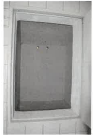
Wohngebäude / Zubau EG / Ölraum
