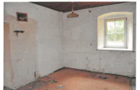
Wohngebäude EG / Küche / Feuchteschaden
