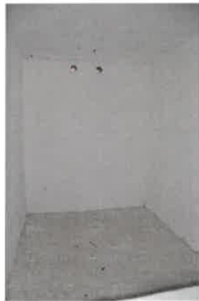
Wohngebäude / Zubau EG / Ölraum
