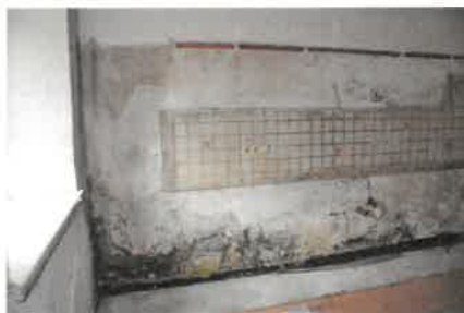
Wohngebäude EG / Küche / Feuchteschaden
