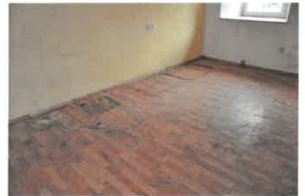
Wohngebäude EG / Schlafzimmer 1/ Zustand Laminat
