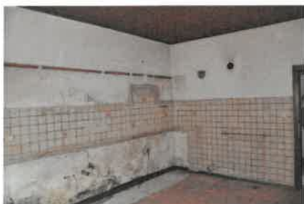
Wohngebäude EG / Küche / Feuchteschaden
