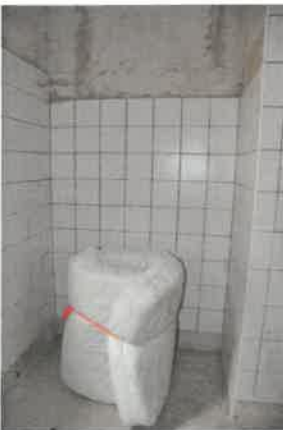
Wohngebäude / Zubau EG / Heizraum
