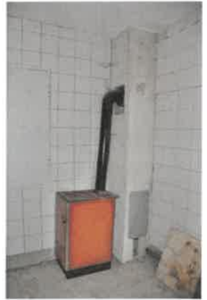
Wohngebäude / Zubau EG / Heizraum
