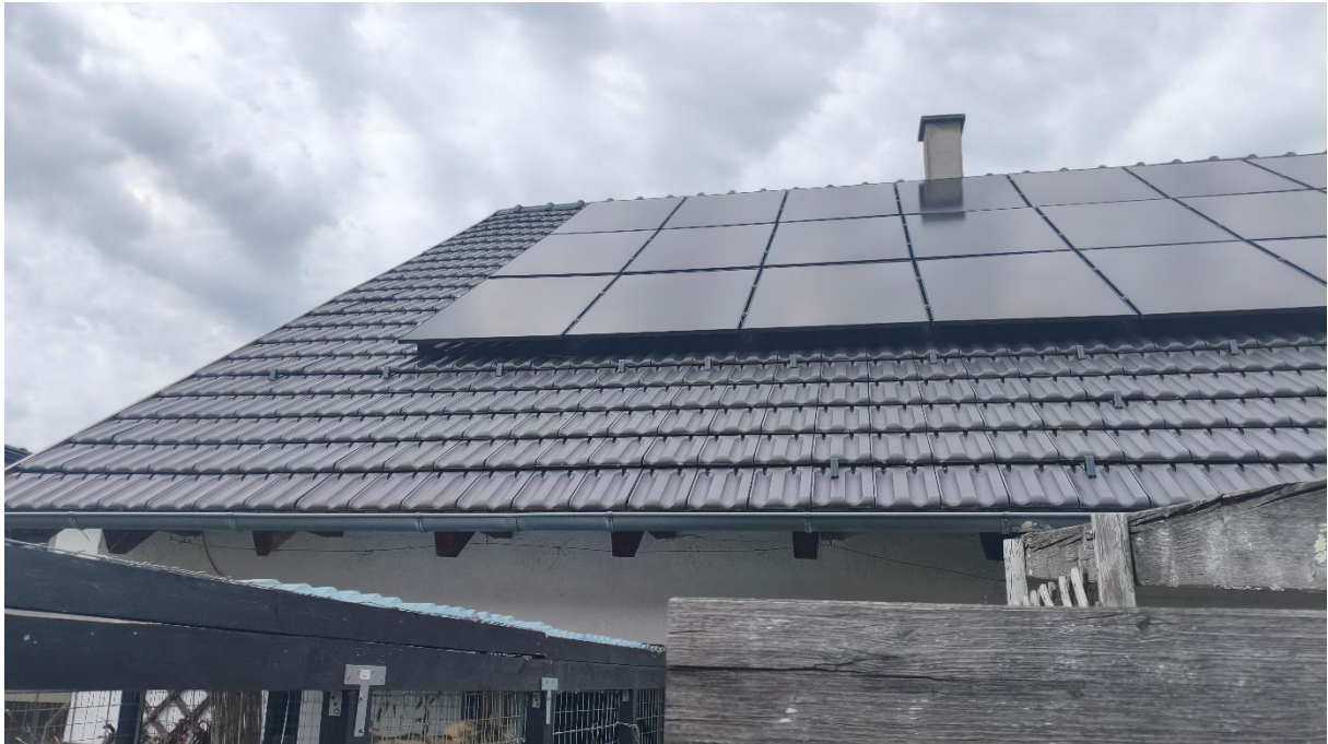
Das Gebäude ist mit einer, nach Süd-Osten ausgerichteten, PV Anlage ausgestattet.
