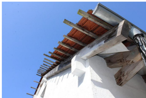
Fertigstellungs- und Reparaturbedarf
