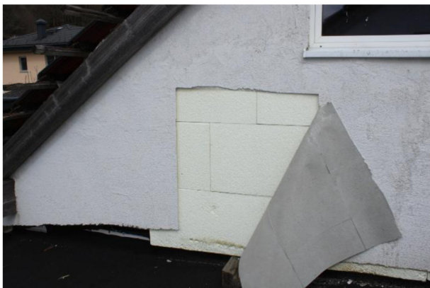
Fassadenmängel und Schäden
