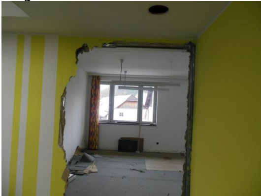
Ausgebrochene Türe im OG
