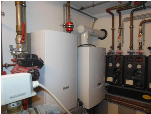
Heizraum mit Gastherme im KG
