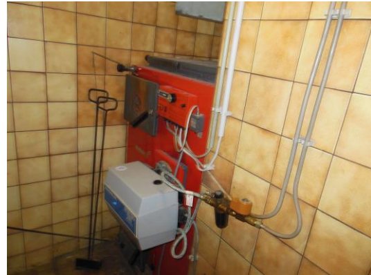
Heizraum im KG
