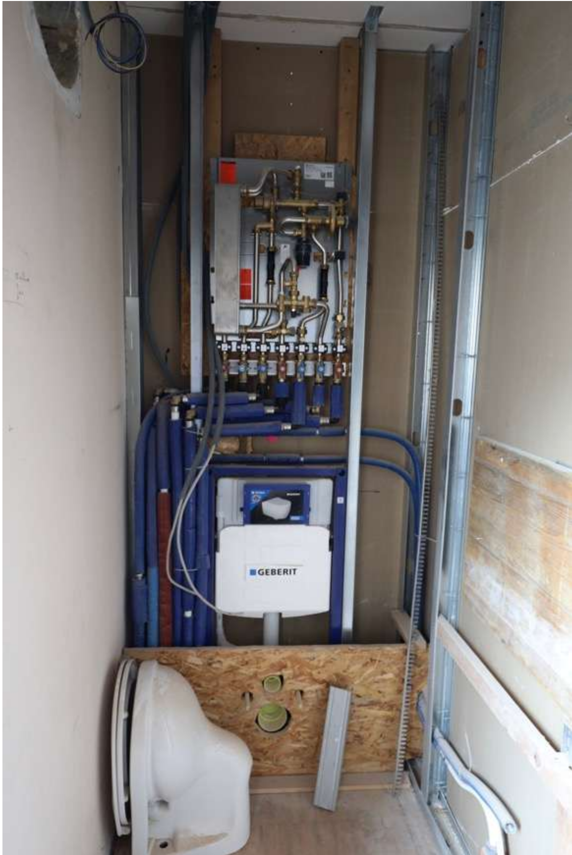
Technik im 1. OG; Fertigstellungsarbeiten nach Baustopp eingestellt
