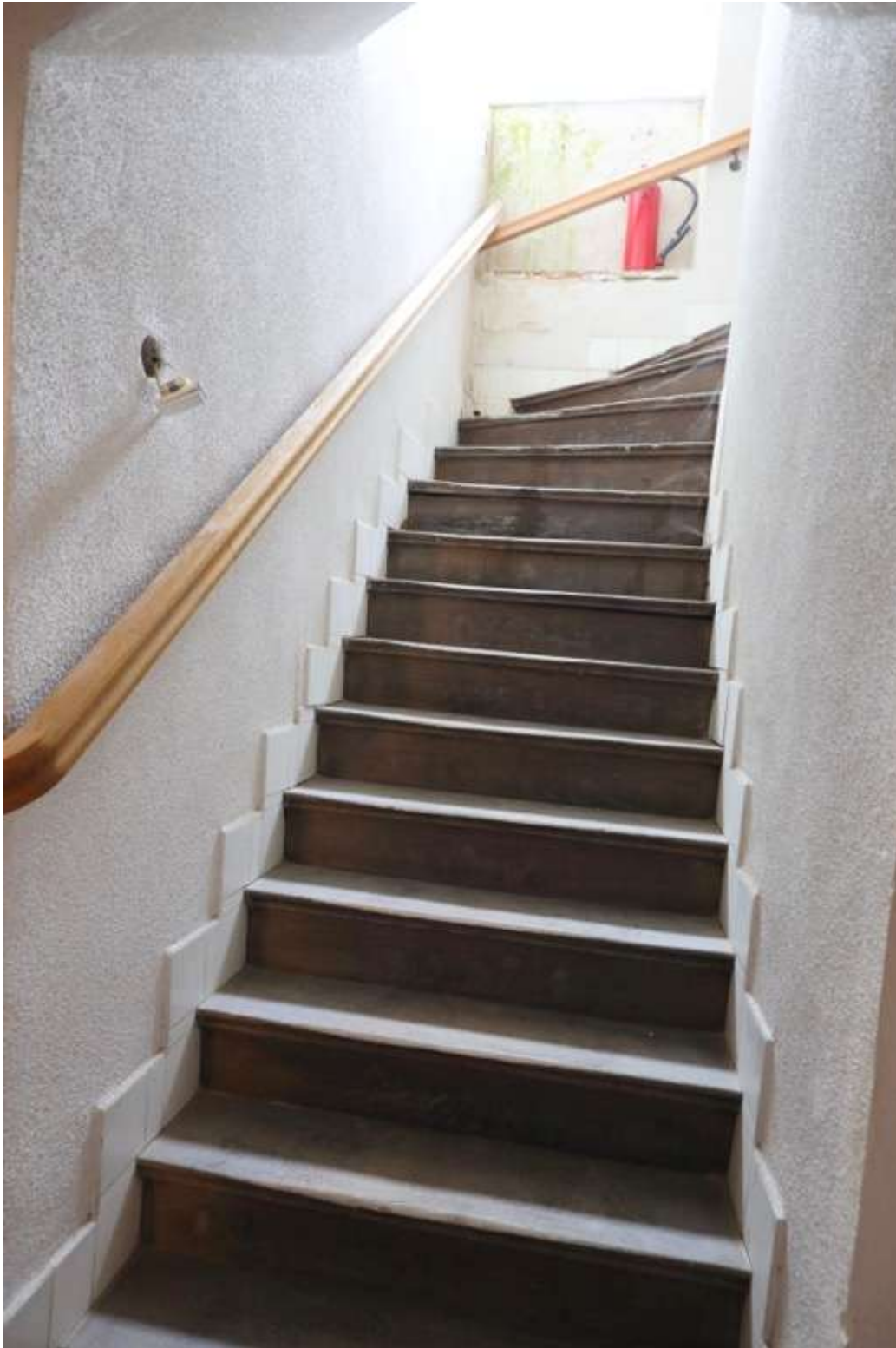
Treppe zu 1. OG; Treppe ist lt. Auskunft der Eigentümer zu steil und daher nicht genehmigungsfähig; 2. Handlauf fehlt;
