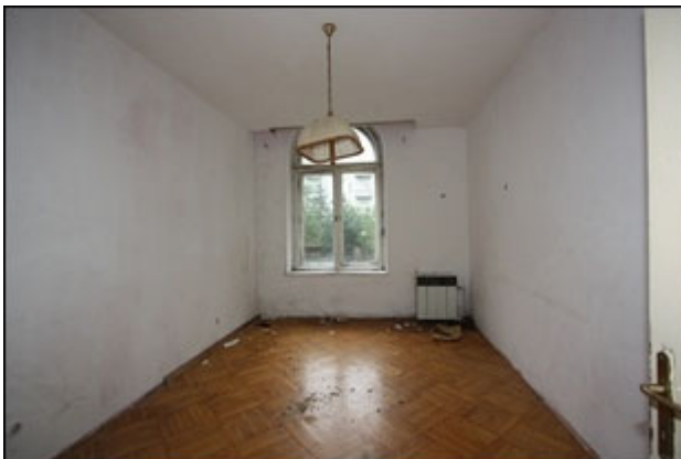
Abb.65 Ansicht Wohnung West (EG), Taubenkot
