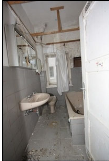
Abb.94 Ansicht Wohnung West (1.OG), Taubenkot
