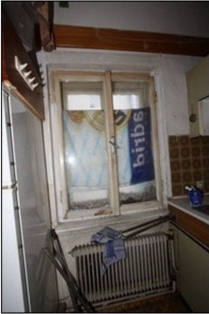
Abb.123 Ansicht Wohnung West (2.OG), Taubenkot
