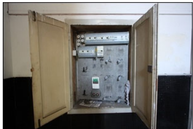
Abb.20 Ansicht Detail zu Abb.19, Zählerkasten
