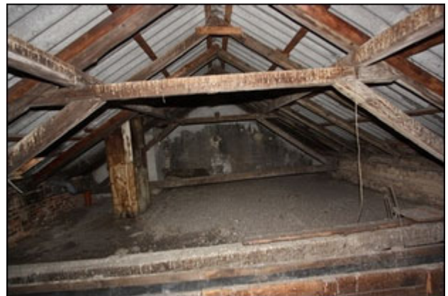
Abb.36 Ansicht Dachboden, Taubenkot
