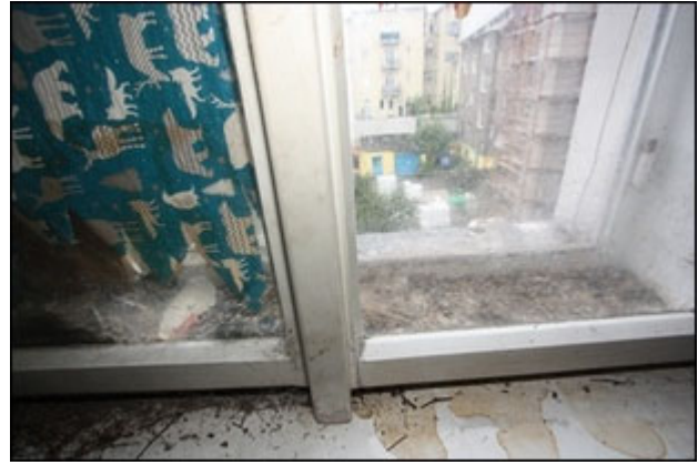
Abb.116 Ansicht Wohnung West (2.OG), Taubenkot
