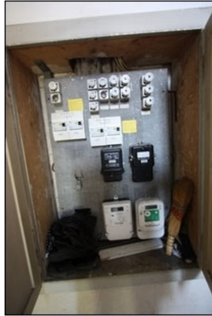
Abb.22 Ansicht Zählerkasten 1.OG
