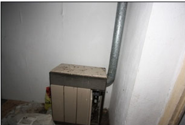
Abb.91 Ansicht Detail zu Abb.90, Taubenkot
