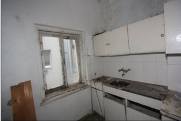
Abb.93 Ansicht Wohnung West (1.OG), Taubenkot
