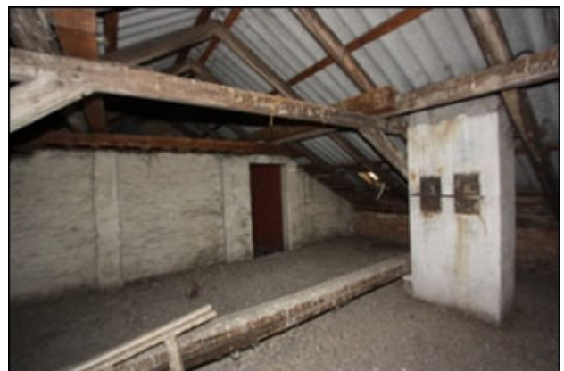
Abb.38 Ansicht Dachboden, Taubenkot
