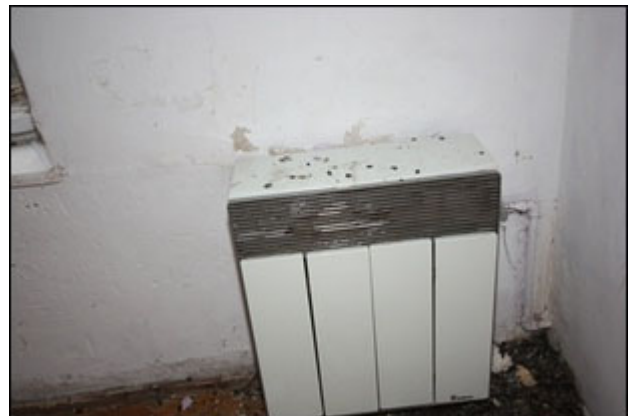
Abb.66 Ansicht Detail zu Abb.65, Taubenkot
