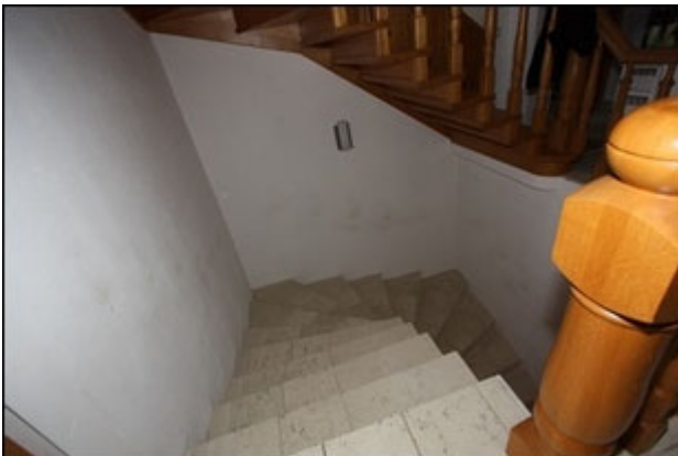
Abb.65 Ansicht Wohngebäude, Stiege EG/KG, ohne Geländer (!)
