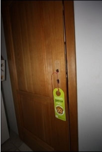
Abb.15 Ansicht Wohngebäude EG, Zustand Tür (Griff etc. fehlt)
