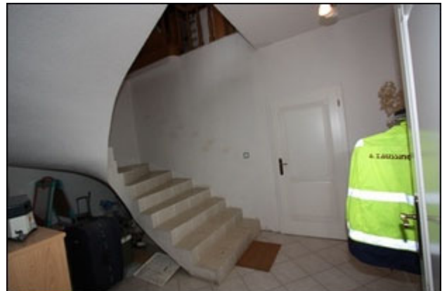
Abb.66 Ansicht Wohngebäude, Stiege EG/KG, ohne Geländer (!)
