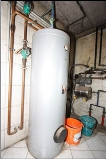
Abb.75 Ansicht Wohngebäude KG, Heizraum
