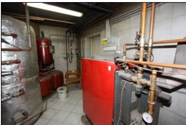
Abb.73 Ansicht Wohngebäude KG, Heizraum
