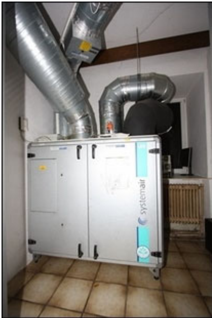
Abb.227 Ansicht Hauptgebäude EG, Lüftungstechnik
