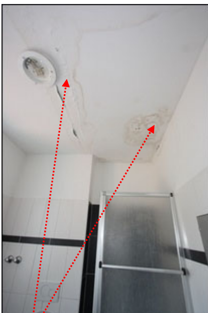
Abb.67 Ansicht Hauptgebäude 1.OG (Fremdenzimmer), Detail Wasserschaden
