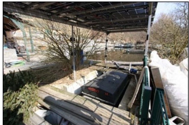
Abb.290 Ansicht Equipment Fichteich (Mieterinvestition)
