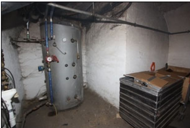
Abb.121 Ansicht Hauptgebäude KG, Heizraum
