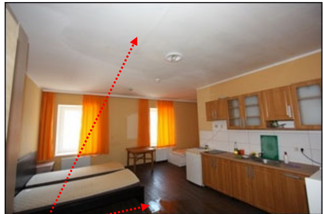
Abb.74 Ansicht Hauptgebäude 2.OG (Fremdenzimmer), Wasserschaden
