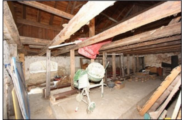
Abb.178 Ansicht Anbau Süd (UG), Teilfl. Ost (Raum desolat), darunter lt. Auskunft und Lageplan (Beilage 4.2): Senkgrube
