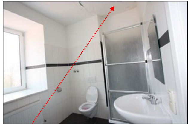
Abb.66 Ansicht Hauptgebäude 1.OG (Fremdenzimmer) Wasserschaden
