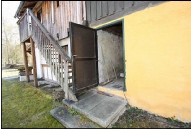
Abb.177 Ansicht Anbau Süd (UG), Teilfläche Ost
