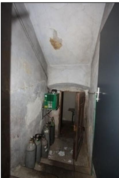
Abb.103 Ansicht Hauptgeb. KG, Abgang kl. Keller Nord
