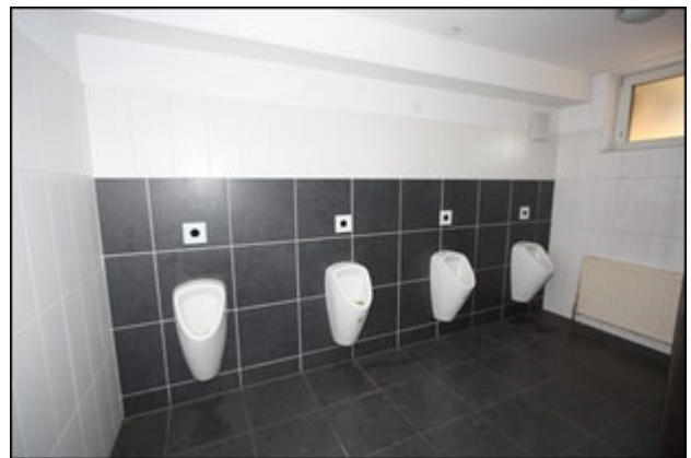
Abb.108 Ansicht Hauptgebäude KG, WC-Anlagen (Gastronomie)
