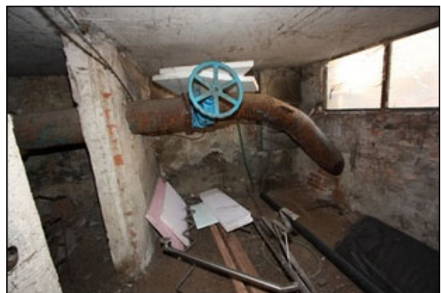
Abb.182 Ansicht Anbau Süd (UG), Teilfläche Ost (Raum desolat, Abschnitt ehem. Turbine/Generator)
