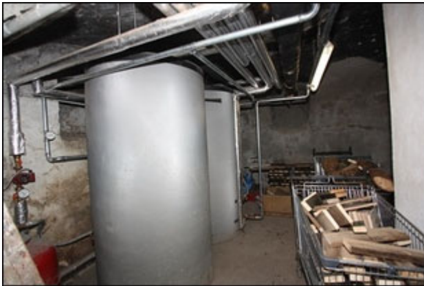
Abb.119 Ansicht Hauptgebäude KG, Heizraum
