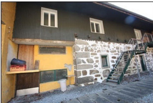
Abb.175 Ansicht Anbau Süd (UG), Teilfläche Ost
