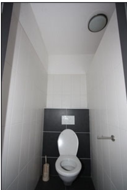
Abb.109 Ansicht Hauptgebäude KG, WC-Anlagen (Gastronomie)
