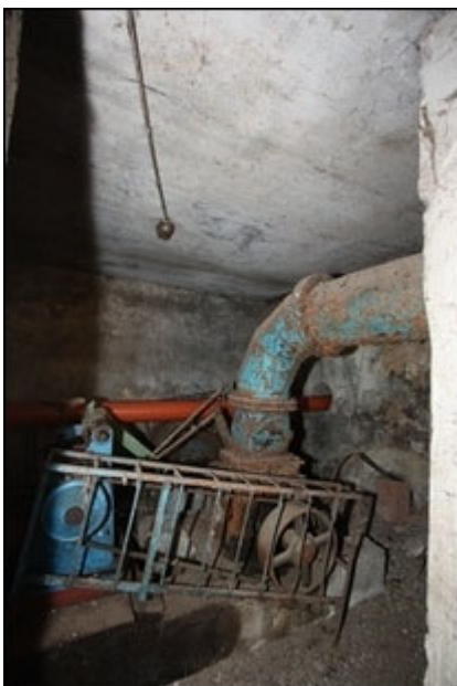
Abb.181 Ansicht Anbau Süd (UG), Teilfläche Ost (Raum desolat, Abschnitt ehem. Turbine/Generator)
