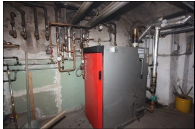
Abb.120 Ansicht Hauptgebäude KG, Heizraum
