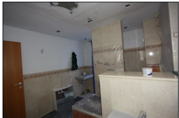
Abb.52 Ansicht Wohngebäude (DG), Bad/WC (zum Stichtag im Teilsanierungszustand nach Wassereintritt)
