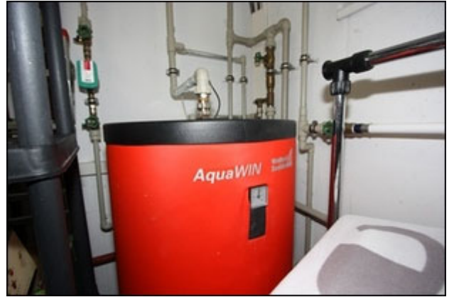
Abb.28 Ansicht Boiler (Technikraum)
