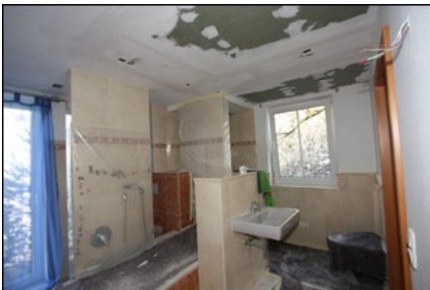
Abb.51 Ansicht Wohngebäude (DG), Bad/WC (zum Stichtag im Teilsanierungszustand nach Wassereintritt)
