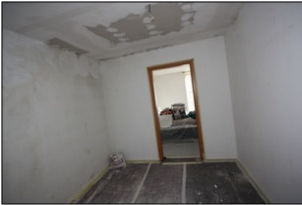
Abb.53 Ansicht Wohngebäude (DG), Schrankraum (zum Stichtag im Teilsanierungszustand nach Wassereintritt)
