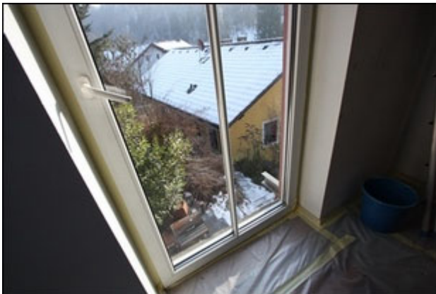
Abb.55 Ansicht Detail zu Abb.54 (Balkontüre, Balkon nicht errichtet, keine Absturzsicherung !!!)
