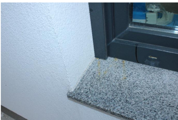
Fensterbank mit zu kurzem Überstand
