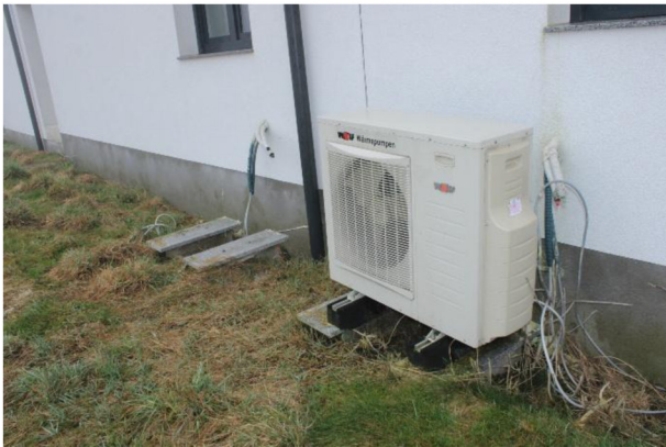
Fehlende Außeneinheit TOP 1
