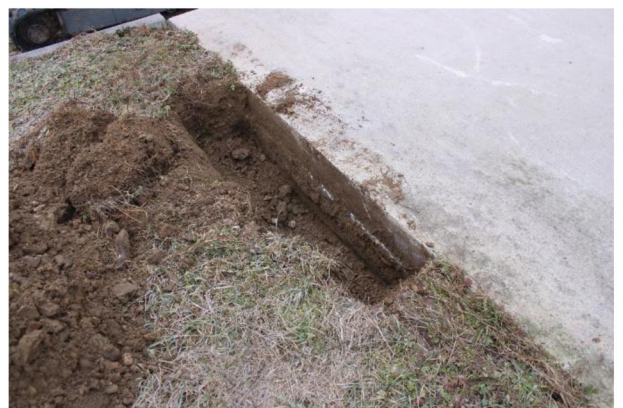
Mangelhafter Unterbau bei den Terrassen
