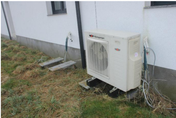
Fehlende Außeneinheit TOP 1
