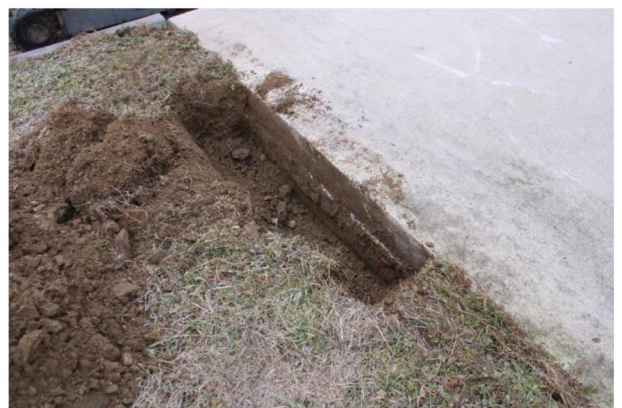
Mangelhafter Unterbau bei den Terrassen
