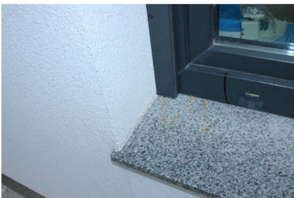
Fensterbank mit zu kurzem Überstand
