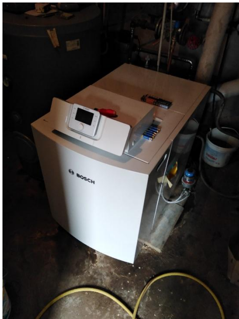
Lfd. Nr. 3 Wirtschaftsgebäude Heizungsraum
