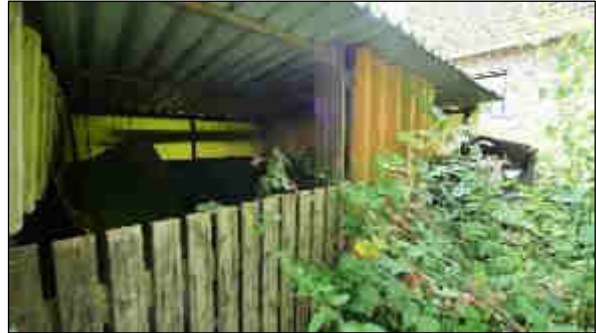
Bild 14: Nebengebäude (nicht genehmigt)
