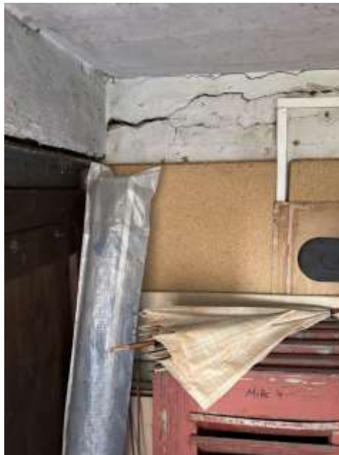
Bild 22: Schadensbild mit Rissbildungen
