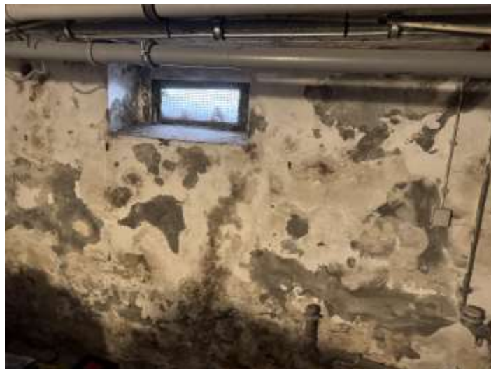
Bild 14: Schadensbild mit Feuchtigkeitsmerkmalen und Putz- und Anstrichschäden an der Keller- außenwand
