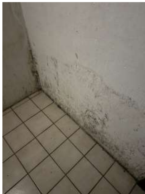
Bild 36: Schadensbild mit Feuchtigkeit im Keller
