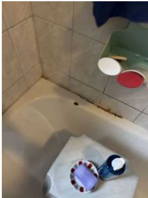
Bild 28: Innenansicht 1. OG rechts/Schadensbild
