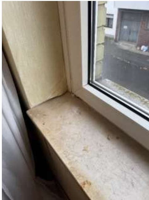
Bild 31: Innenansicht 1. OG rechts/Schadensbild
