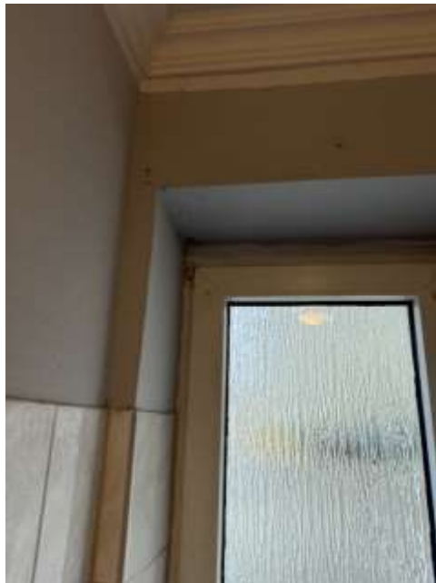
Bild 30: Innenansicht 1. OG rechts/Schadensbild
