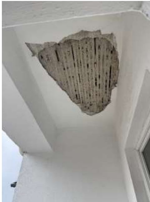
Bild 41: Schadensbild Loggia offene Spalierdecke
