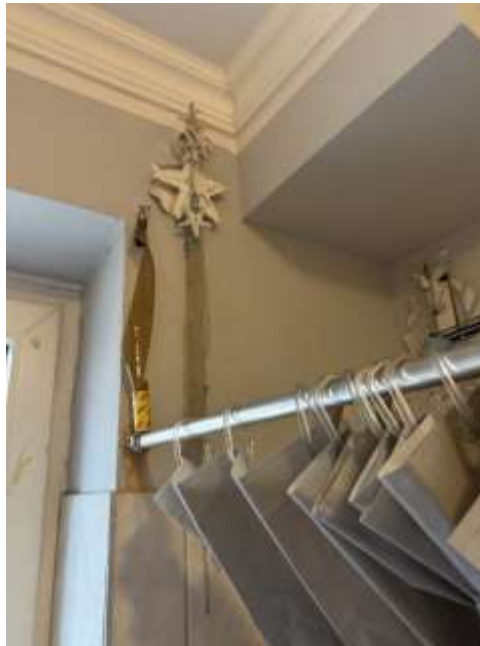
Bild 29: Innenansicht 1. OG rechts/Schadensbild
