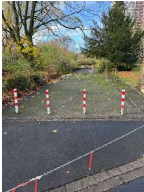
Bild 3: Zufahrt Tiefgarage (Nutzungsuntersagung)
