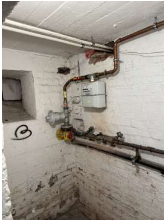
Bild 11: Hausanschlüsse ; Feuchtigkeitsmerkmale in den Kelleraußenwänden
