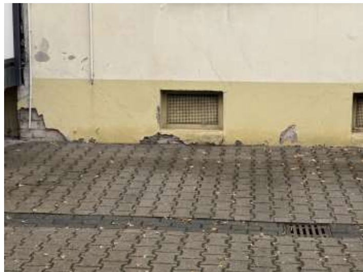
Bild 14: Schadensbild Sockelbereich Gebäuderückseite
