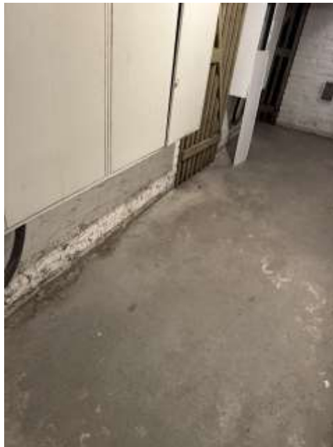
Bild 10: Kellergeschoss (Feuchtigkeiten Sockelbereich)
