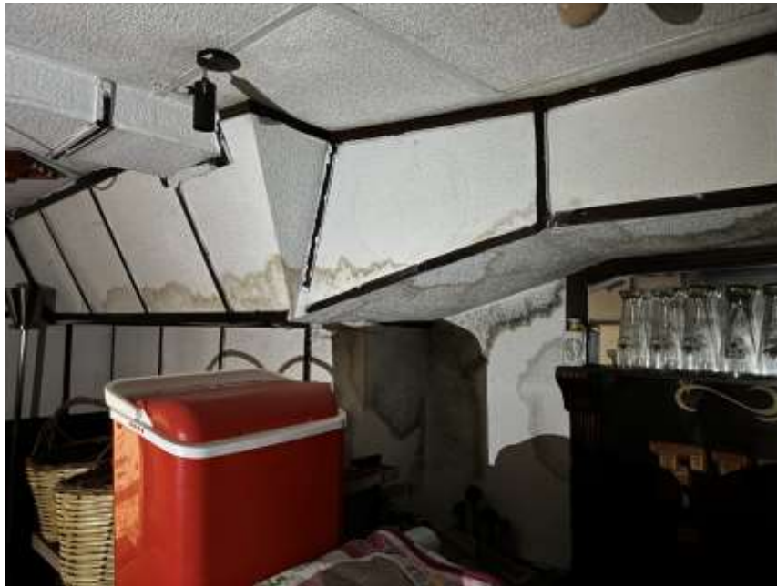
Bild 15: Kellerausschnitt (Wasserschaden Partykeller)
