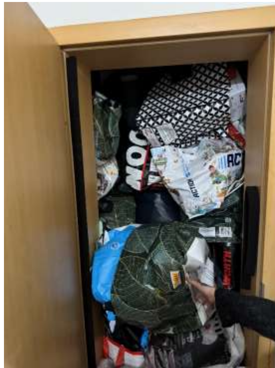
Bild 41: SE Nr. 5 versperrter Zugang zum Spitzboden
