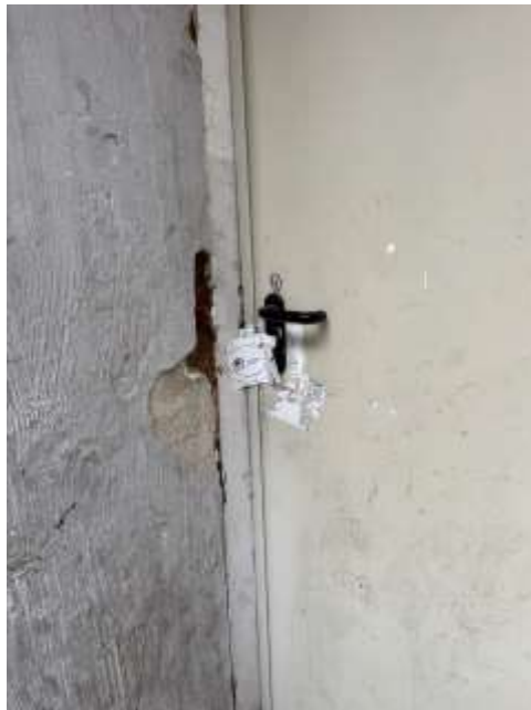
Bild 8: Schadensbild/Eingang geschlossen durch die Taskforce
