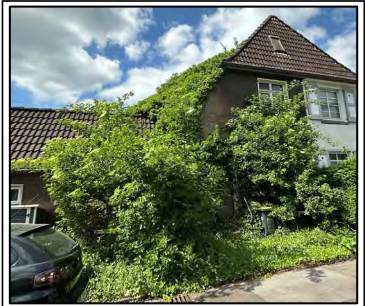
Bewuchs der südlichen Dachfläche
