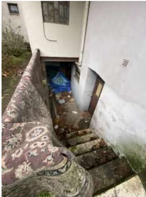
Bild 15: Kelleraußentreppe mit Feuchteschäden
