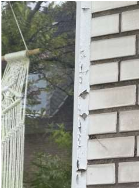
Bild 10: Fassade mit Beschädigungen
