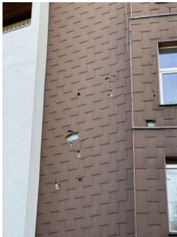
Bild 22: Schadensbild rückseitige Fassade
