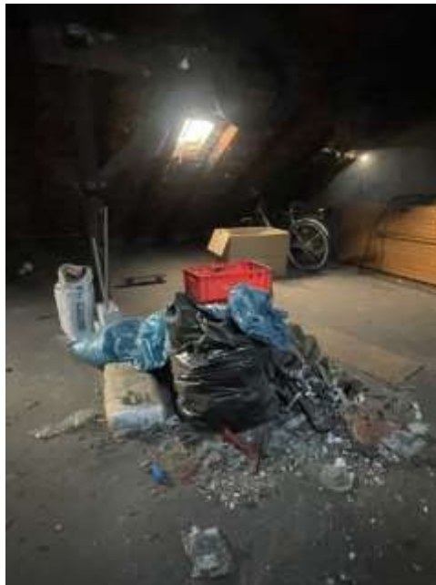
Bild 16: Dachgeschoss mit Unrat und Müll
