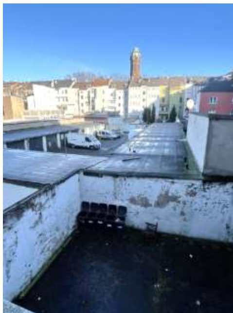
Bild 20: Ansicht in den Hof mit beschädigter Hofmauer
