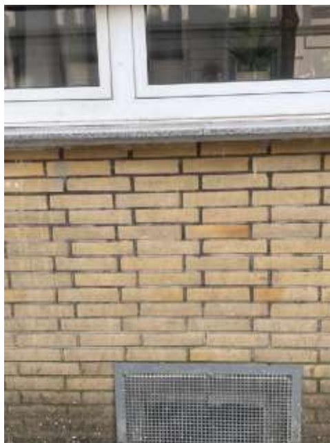
Bild 22: Straßenseitige Fassade mit Feuchtigkeitsmerkmalen in den Fugen
