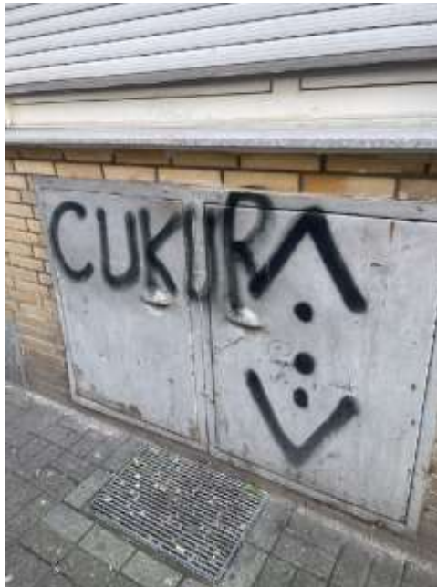
Bild 21: Straßenseitige Fassade und Türen zu den Mülltonnenboxen mit Graffiti Beschmierungen
