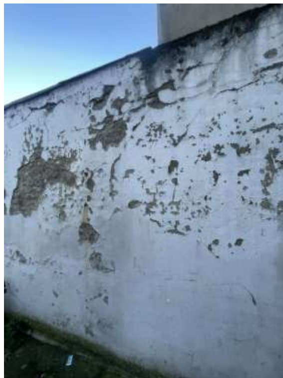
Bild 18: Hofmauer mit Putz- und Anstrichschäden
