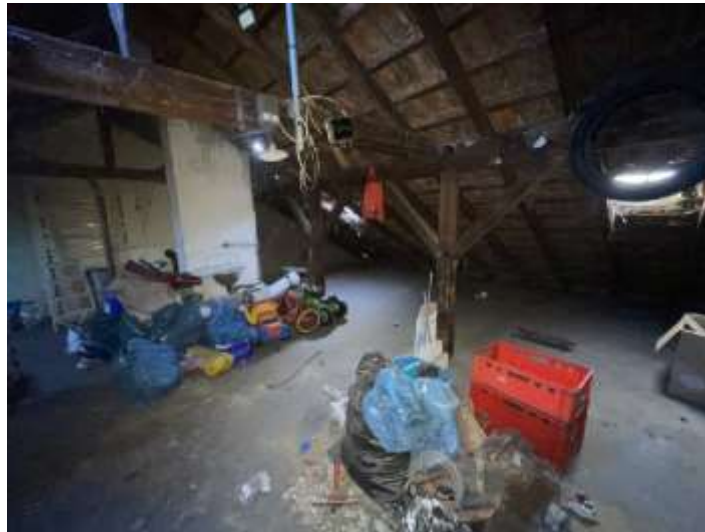
Bild 17: Dachgeschoss mit Unrat und Müll
