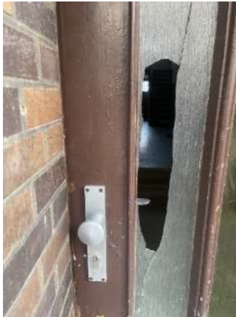
Bild 19: Hauseingangstür mit beschädigtem Glaseinsatz
