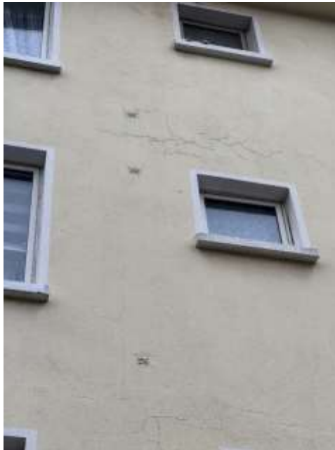
Bild 29: Schadensbild rückseitige Fassade
