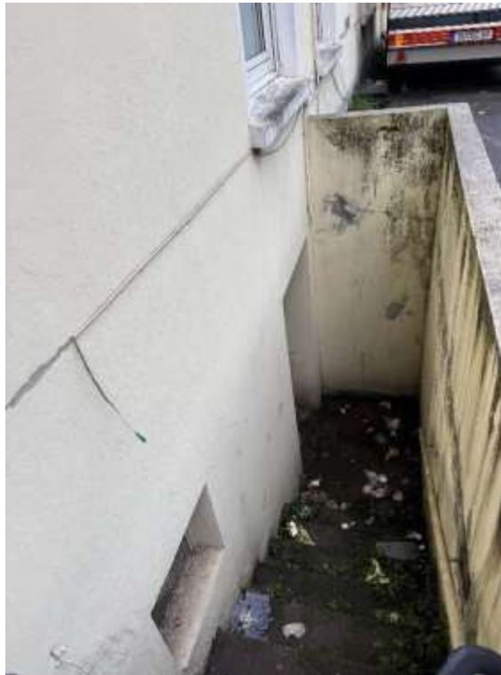
Bild 11: Kelleraußentreppe mit Feuchtigkeiten
