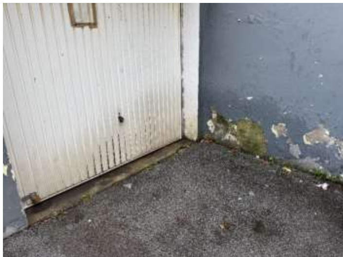
Bild 8: Garagen mit Feuchtigkeiten
