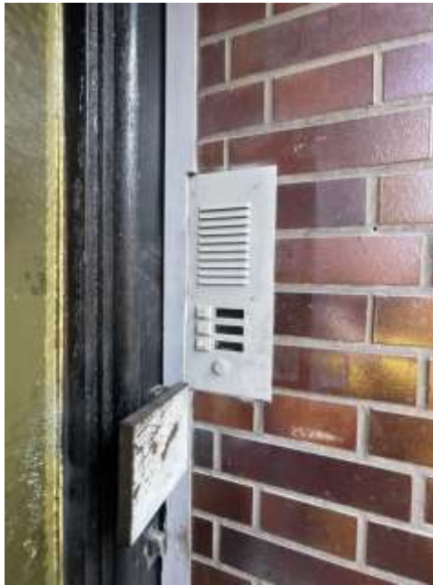
Bild 7: Klingeltafel / beschädigter Hauseingang
