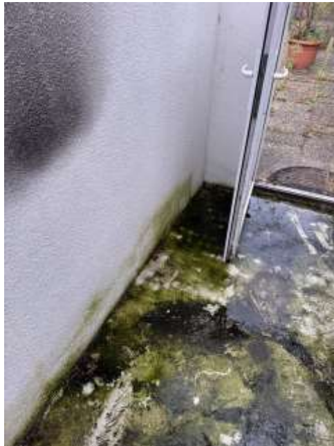
Bild 37: Feuchtigkeiten Terrasse / Garage
