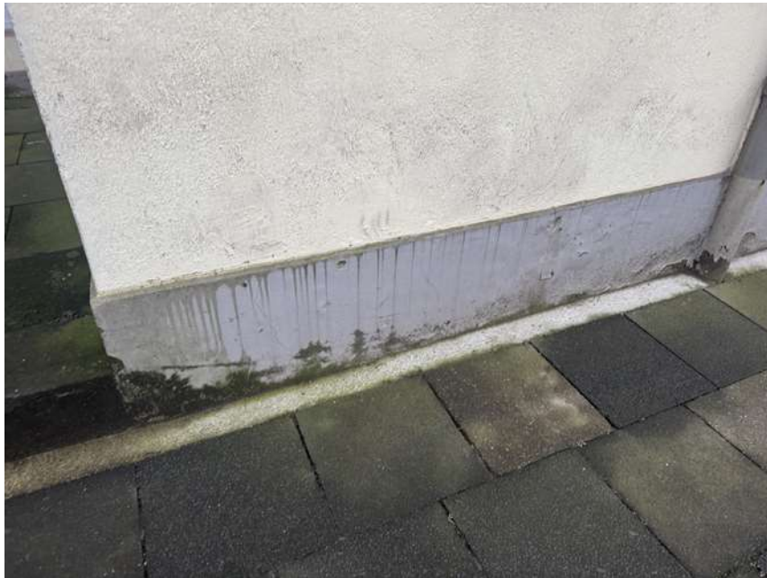
Bild 11: Feuchtigkeitsmerkmale im Sockelbereich der Fassade
