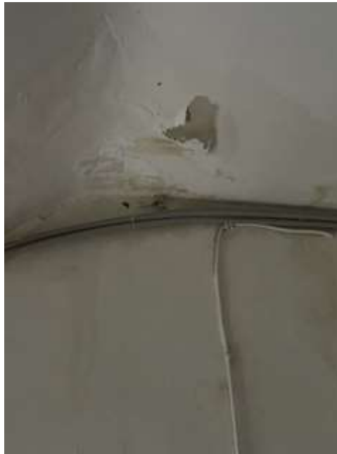
Bild 39: Putzschaden im Hausflur Roonstraße 69
