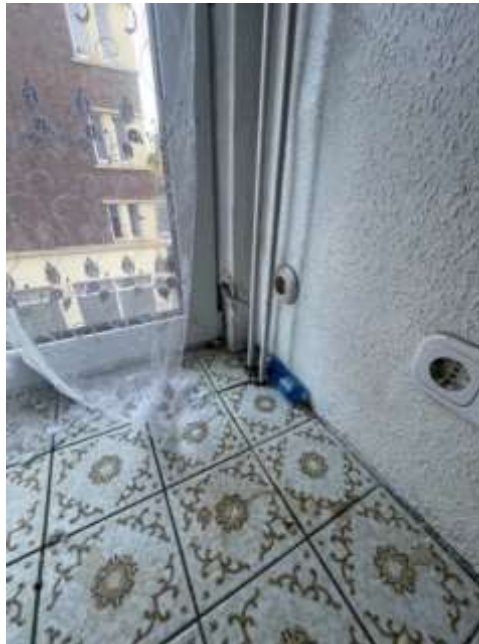
Bild 51: Feuchtigkeitsmerkmale in der Wohnung Roonstraße 69 2.OG links
