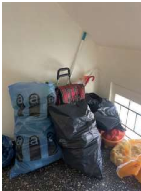
Bild 62: Treppenhaus Roonstraße 71 mit Brandlasten
