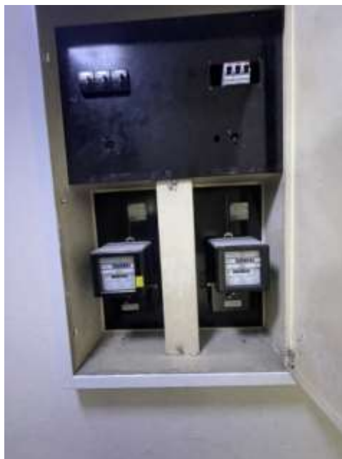
Bild 42: Beispielhafter Zählerschrank Roonstraße 69
