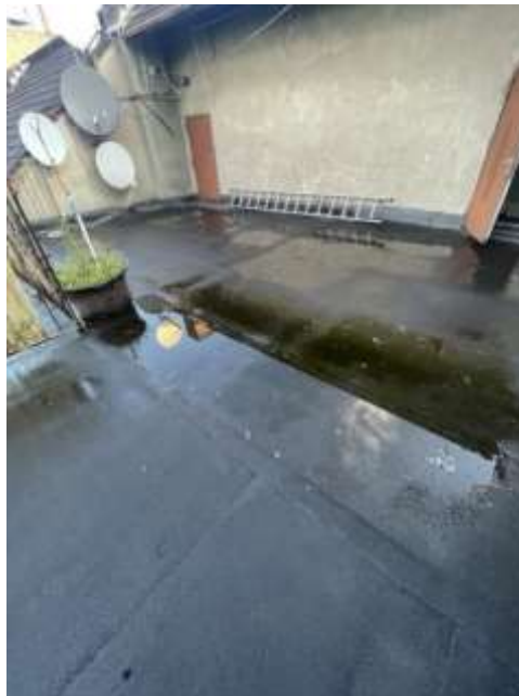
Bild 36: Dachfläche mit Wasseransammlung
