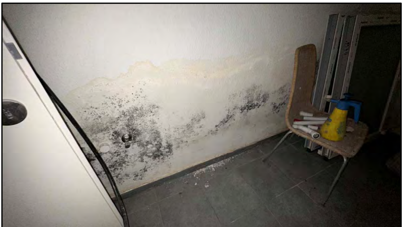
Feuchtschäden im Kellergeschoss
